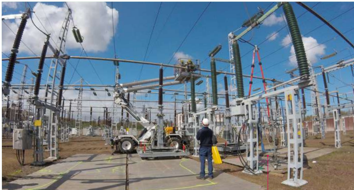
Chantier réalisé sous tension au poste électrique de Grande-Synthe qui alimente de nombreux clients (59)
