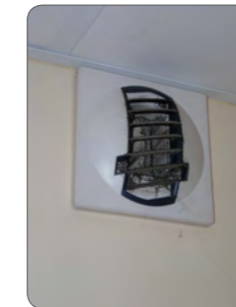
Bouche d'extraction encrassée
