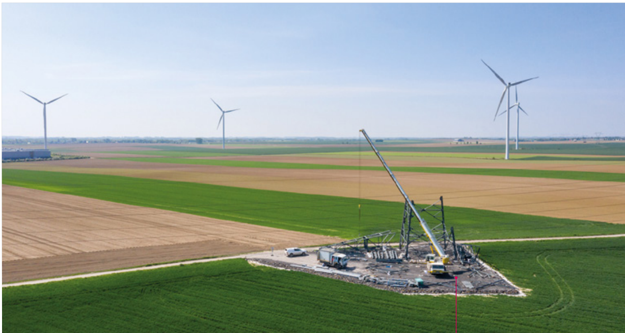
Exemple d'un chantier RTE qui permet notamment une meilleure intégration des énergies renouvelables.
