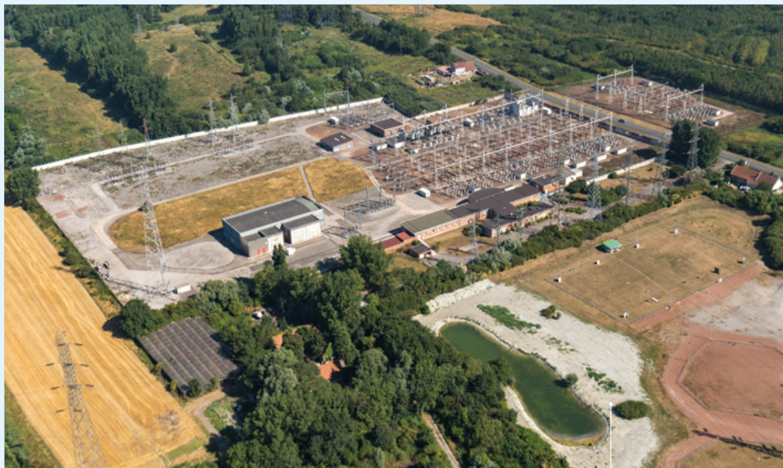
Poste électrique de Grande-Synthe (59) alimentant plusieurs clients industriels actuels et futurs
