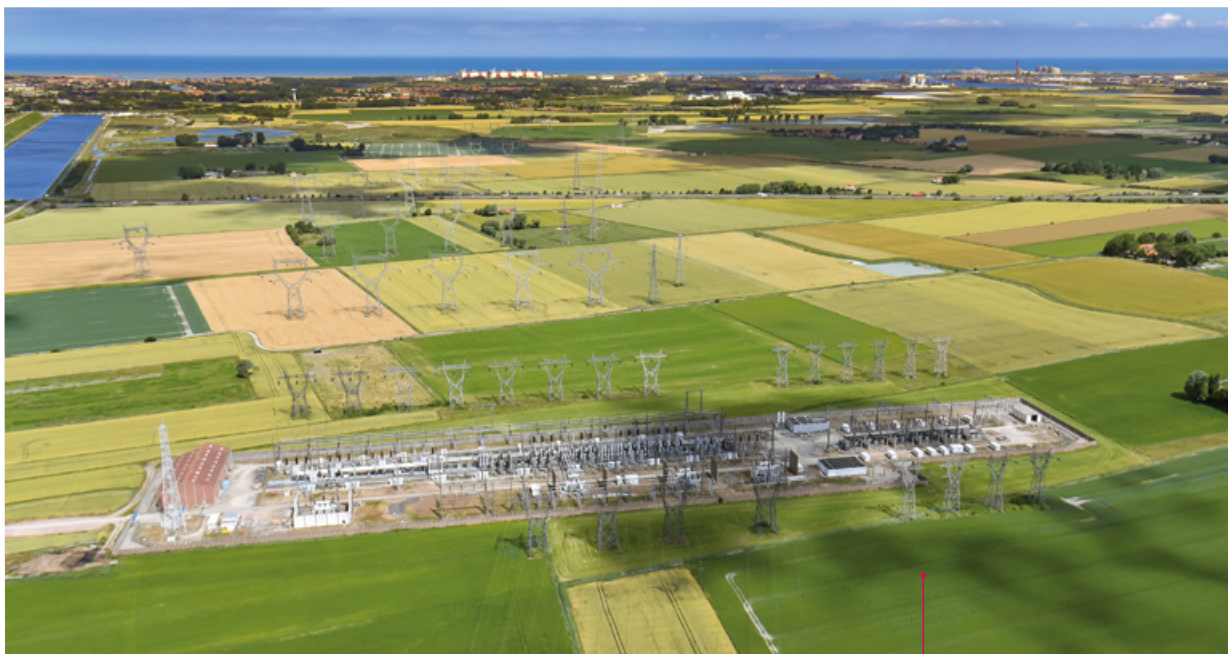
Le poste électrique à Bourbourg (59) qui alimente de nombreux clients.
